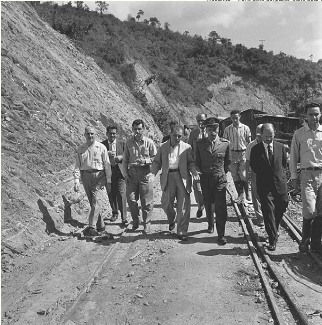
Imagem 05. Adutora do Rio das Velhas, obras, 24/04/1960. Da esquerda para direita: 3º Mário Reis; 4º Prefeito Amintas Barros; 6º Geraldo Magela (de terno preto); 7º Geraldo Fonseca. Fundo: ASCOM/ Arquivo Público da Cidade de Belo Horizonte.
